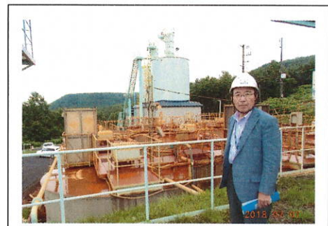
坑内水処理設備
